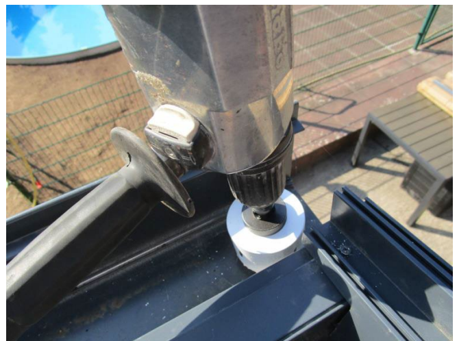
Schritt 8.2 - Laubfangsieb Bohrung 7cm in der Dachrinne bis ganz nach Innen Bohren (wichtig)
