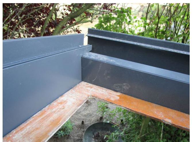
Schritt 4.2d - Den Querträger linker Seite auf schieben und ausrichten, mittels Winkel in allen Ecken
