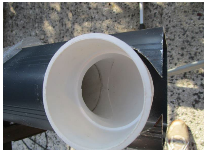
Schritt 9.1b - Pfostenablauf rechts 90 Grad Bogen ausgesägt und eingesetzt und das Rohr dann von oben eingeschoben
