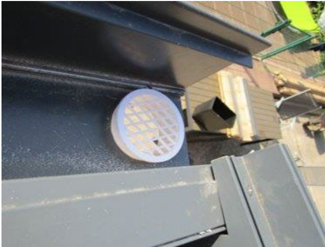
Schritt 8.2a - Pfosten Rechts, Abfluss Dachrinne, hier ganz Rechts und Innen das Bohrloch setzen
