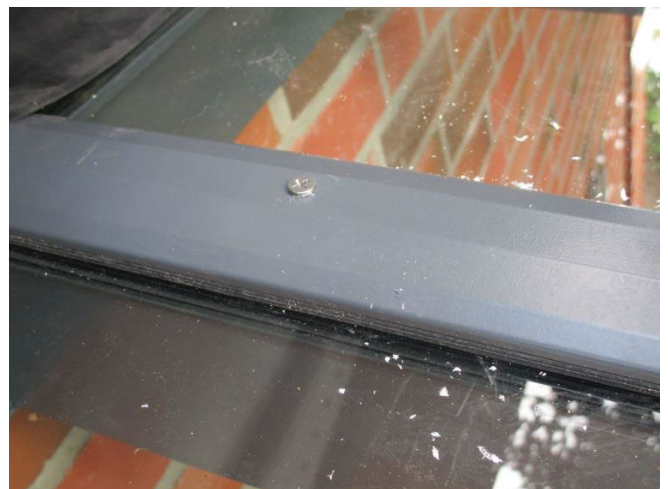
Schritt 28. - An der zweiten Scheibe dann die Abdeckleiste für das Glas anbringen und aufschrauben, vorher vorbohren
